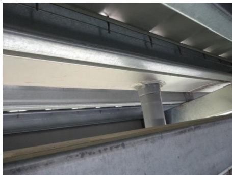
※雨水收集系統設施
