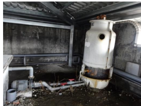
※雨水收集系統設施
